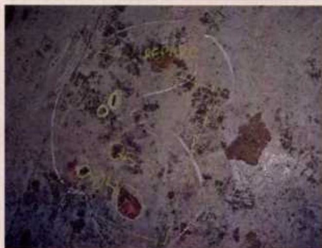
Рис. 4. Выявленные зоны коррозии после снятия защитного покрытия
