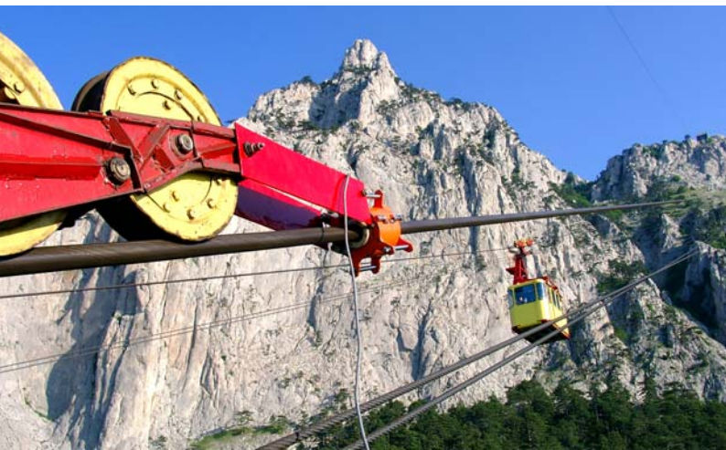
Рис. 5. Контроль несущего каната закрытой конструкции диаметром 46 мм с помощью дефектоскопа ИНТРОС. ППКД «Мисхор — Ай-Петри», Ялта
