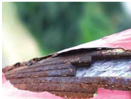
Фото 1. Дефекты вант моста через Рейн
